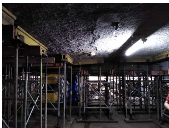
Figura 23: Subsolo do bloco G3. Detalhe das linhas de escoramento das vigas que se apoiam no pilar P62, o qual apresenta recalque excessivo em relação aos pilares vizinhos.
