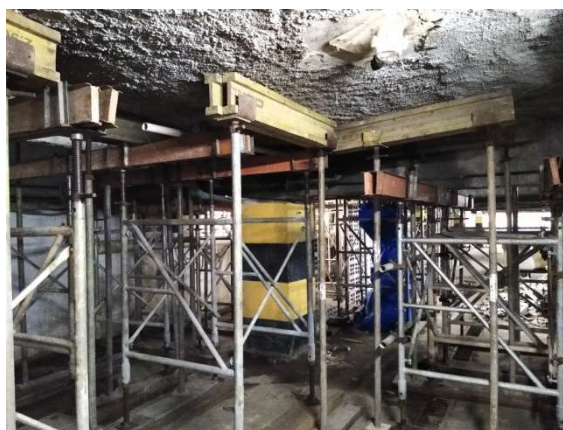
Foto 1: Detalhe das linhas de escoramento no subsolo do bloco G3 das vigas que se apoiam no pilar P62 no, o qual apresenta recalque excessivo em relação aos pilares vizinhos.
